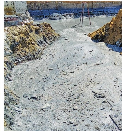
兴华公司建危废库时，挖出此前填埋的危险废物。（经济参考报）
