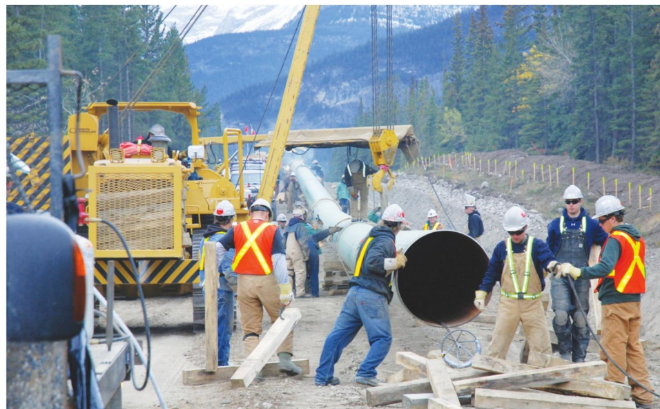
得益于扩建完成的「跨山管道」，中国及其他东亚进口国现在能够获取加拿大丰富的原油储备。
