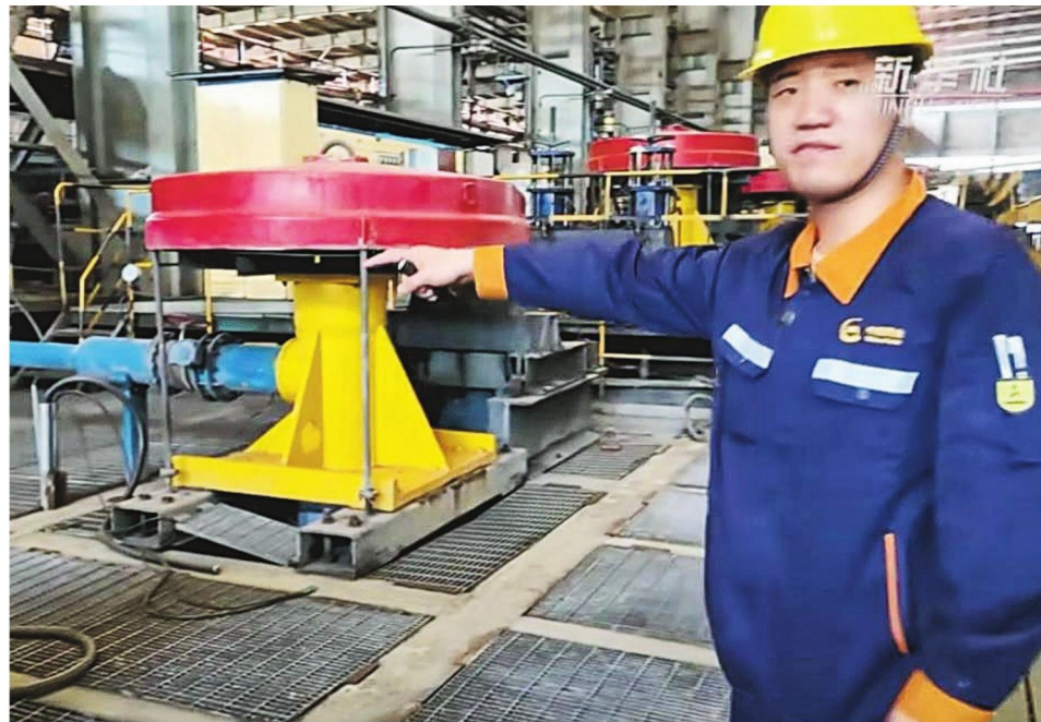
新华社记者日前探访涉事厂区，图为工人指出与事发现场类似的钢格板。
